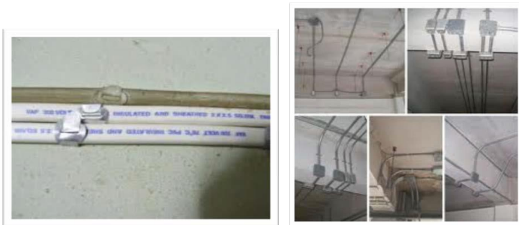
สายไฟเก่าเปลี่ยนสีไปจากเดิม การเดินสายร้อยท่อ / ราง
