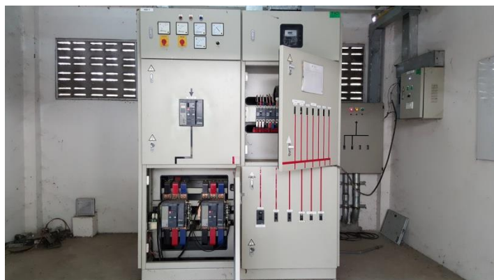
ตู้ควบคุมที่มีผังวงจรควบคุมการทำงาน
